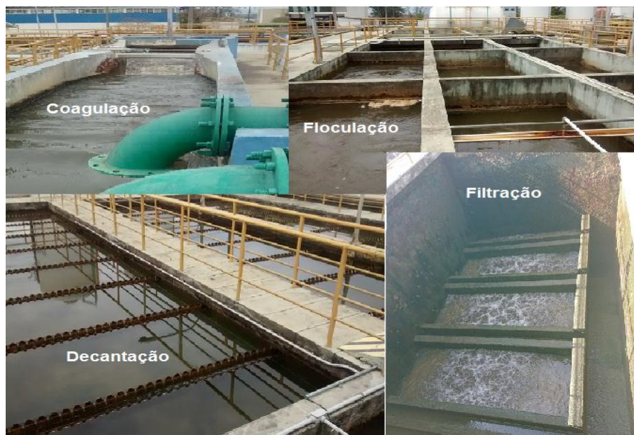
Figura 4 – Unidades de tratamento na ETA Pitangui
