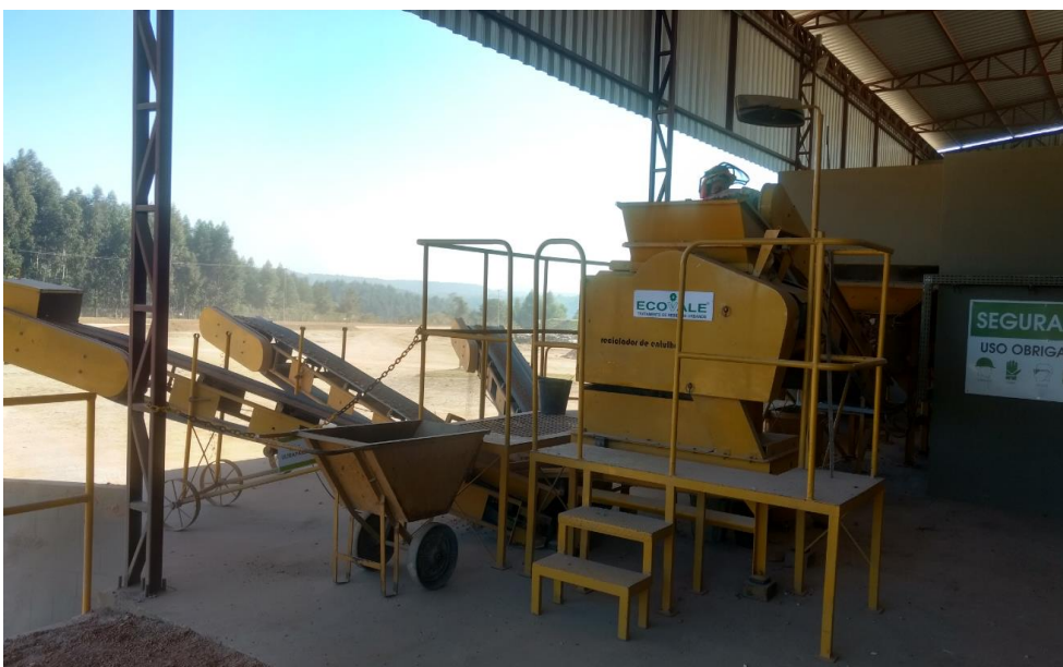
Figura 09 – Britador de RCC
