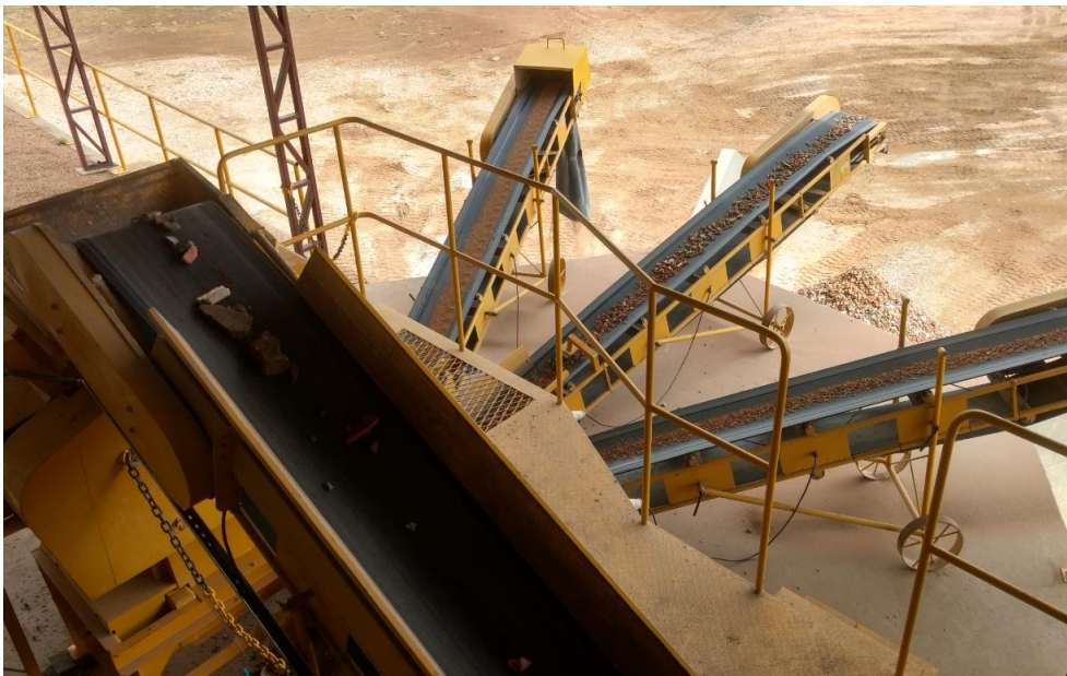
Figura 11 – Esteiras do britador de RCC
